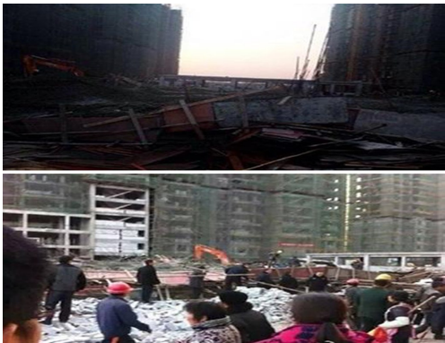
图 2 “12·19”模板支架坍塌事故现场 Fig. 2 “12·19” template stent collapse accident scene
